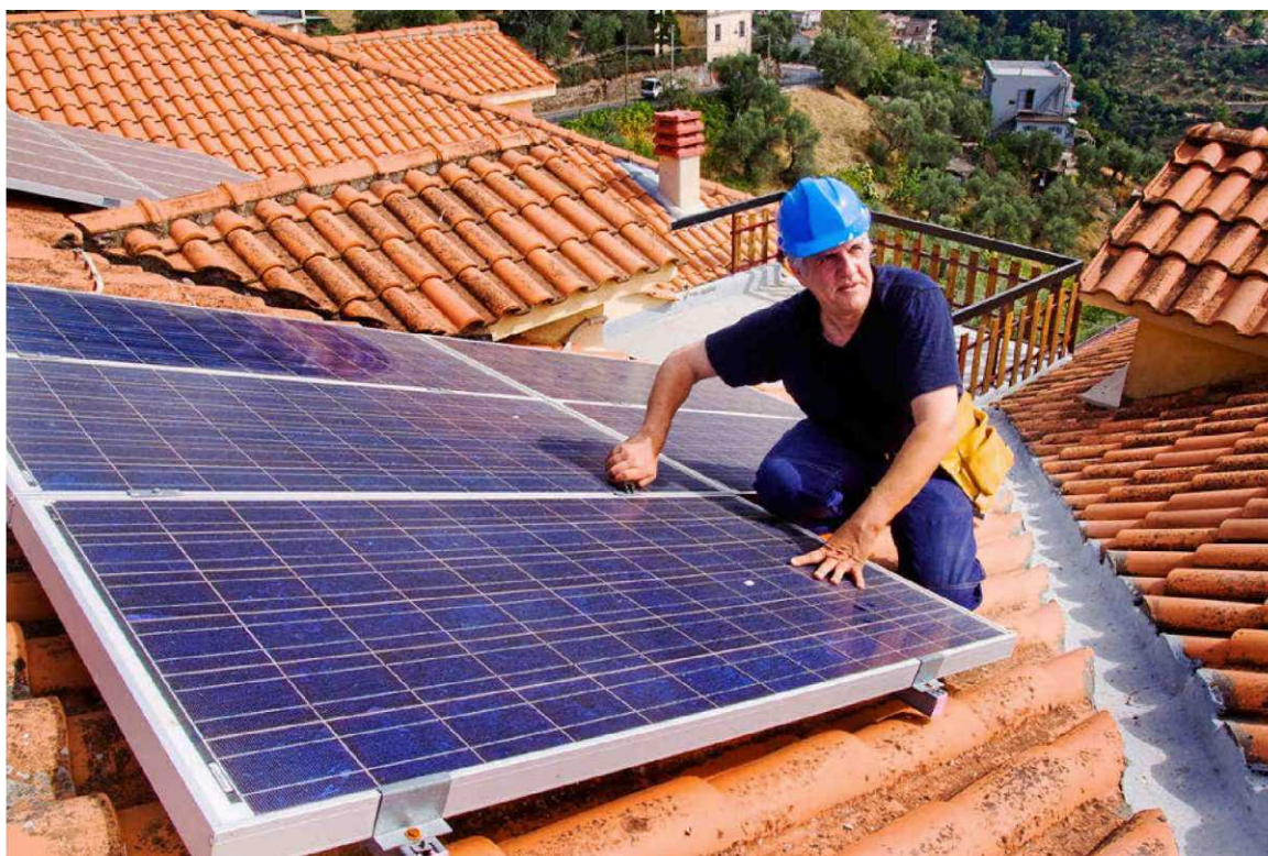
Un técnico instala un panel fotovoltaico en el tejado de una vivienda. FRANCO LUCATO
